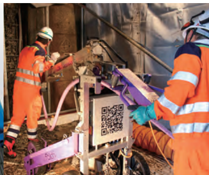
ボックスカルバート補修工事 (ウォータージェット工法)
